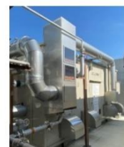
合成原薬製造棟(FJ2)では生産・空調両面でノンフロン設備(自然冷媒)実装済み (写真は自然冷媒タイプの冷凍機)
